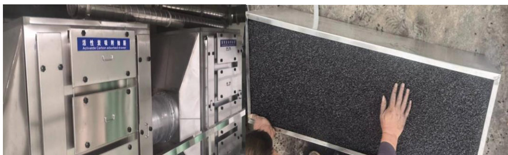
图 3-7 注塑有机废气处理装置
