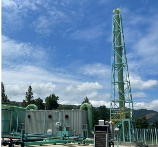
图 3-8 污水处理站臭气处理装置
