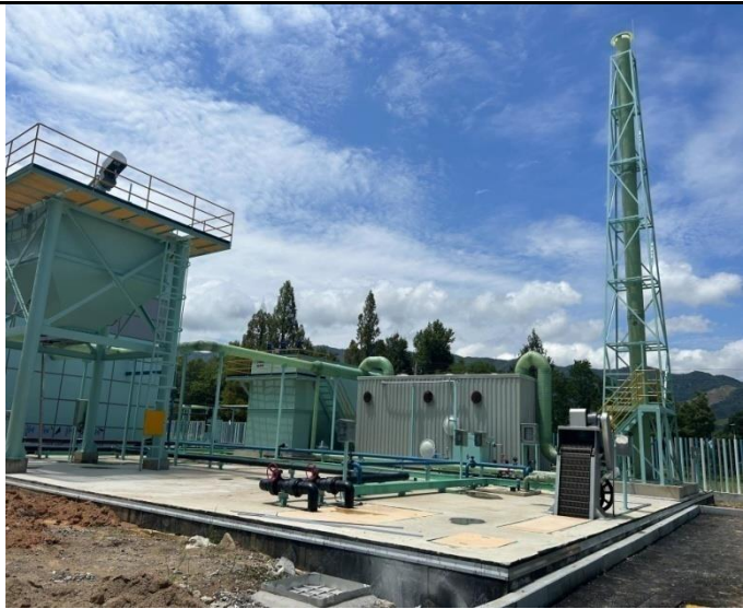
图 3-9 污水处理站现场照片
